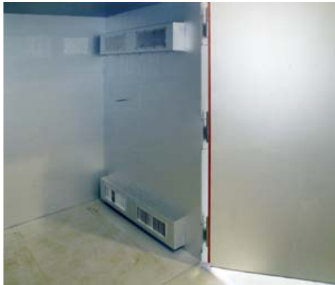
熱風循環用吹出口・吸込み口
